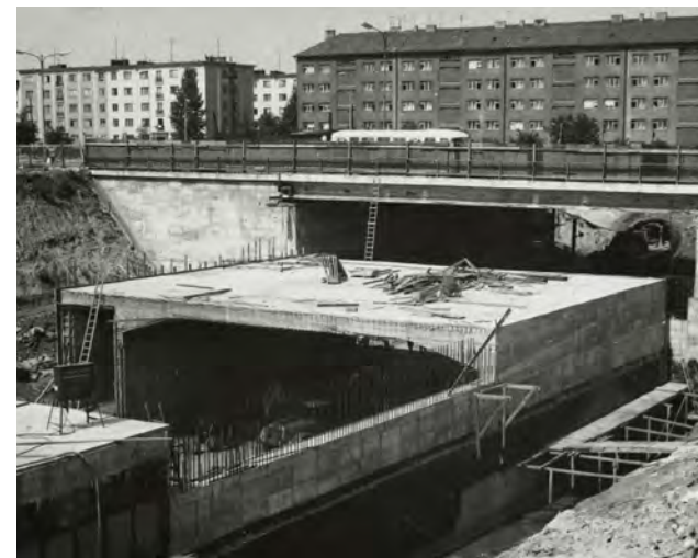
Obrázek 9 Stavba linky metra C, patrné je přemostění ulice Olbrachtova, 1971, zdroj: 40 let DBK, 40let.dbkpraha.cz
