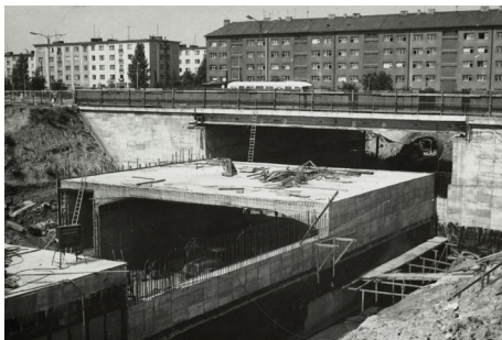
Obrázek 6 Stavba linky metra C, pohled směrem k ulici Olbrachtova, 197, zdroj: 40 let DBK, 40let.dbkpraha.cz
